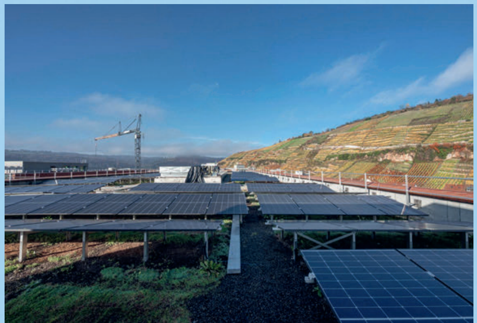
2.750 Quadratmeter Photovoltaik-Anlage auf dem Dach des Neubaus.
